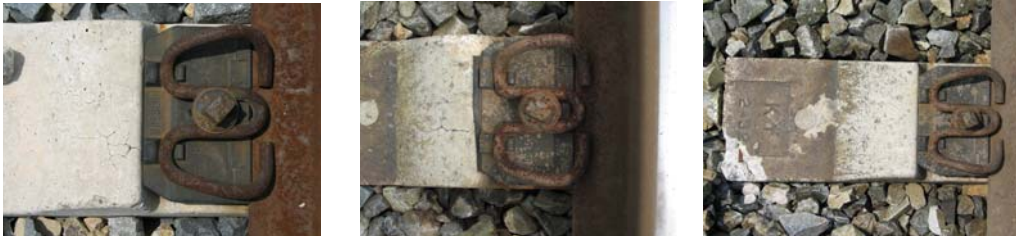
그림 5. B35 침목의 균열 및 손상 사례(화신5터널 시점부)
